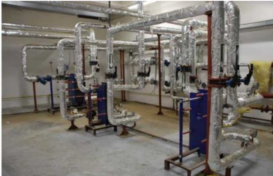
Рис.1.11. Загальний вигляд теплового пункту
