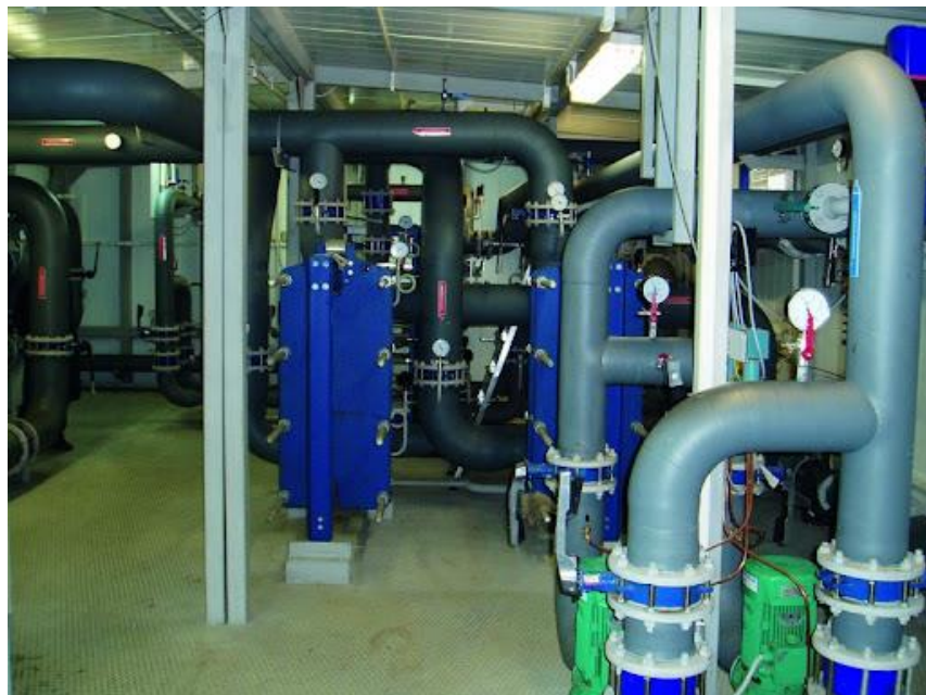
Рис. 1.2. Центральний тепловий пункт
